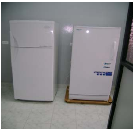
Congeladores para el almacenaje interno pre-procesamiento o almacenaje de la leche humana pasteurizada
