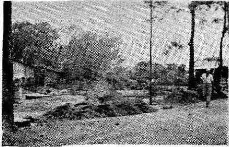
El solar donde se está levantando el edificio para la Unidad Sanitaria
