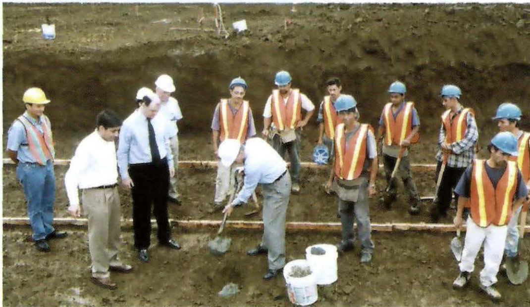
Colocación de la primera piedra para la construcción de la Torre Médica. Hospital Dr. Rafael A. Calderón Guardia
