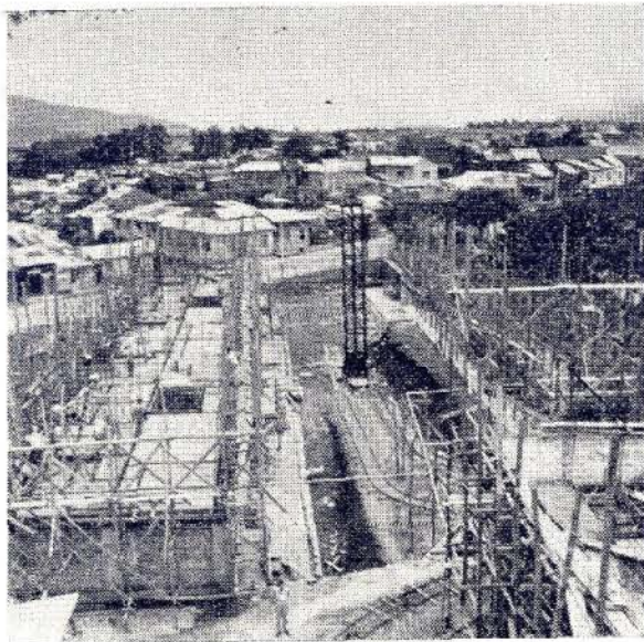
Vista de los 4 edificios en construcción. Nótese los medios mecánicos usados, que fueron contruidos por los propios obreros.
